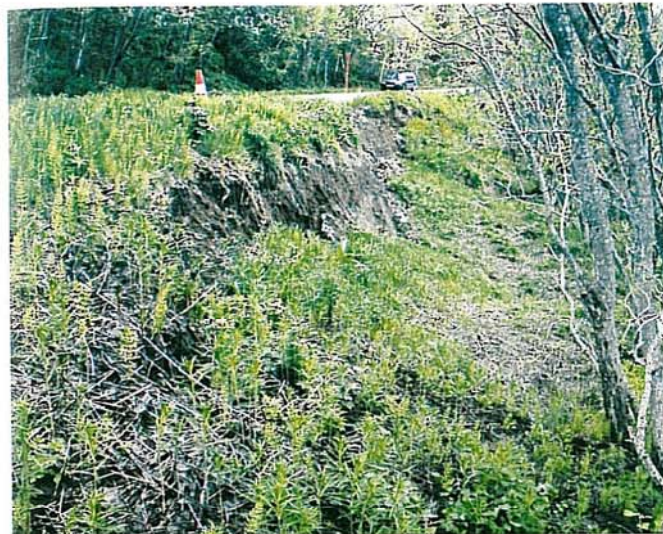
Bilder av ras og utglidninger på fv 294
