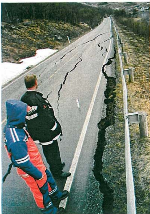
E6 var stengt i nesten 6 dogn fra 23. til 28. mai. Vegen måtte flyttes inn 1/2 vegbredde pga. utglidninger i fjæra. Kostnad for arbeidet med vegomlegging var ca. 1,3 mill.
