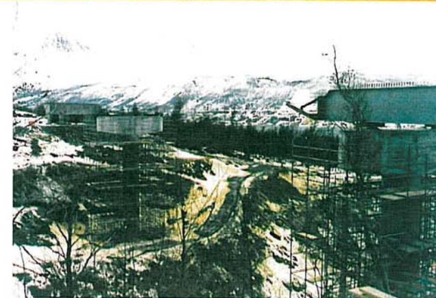
Kvitbergelva bru. Stålbelegene monteres sammen ved det ene landkaret og trekkes ut på pilarene og helt over til motsatt landkar.
