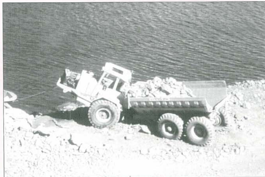
Var kontrollen gjort i dette tilfellet? (fra Løksa-anlegget - Andørja)
