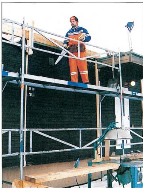
Anleggsbrakkene trenger oppussing - Jan Pedersen i arbeid.
