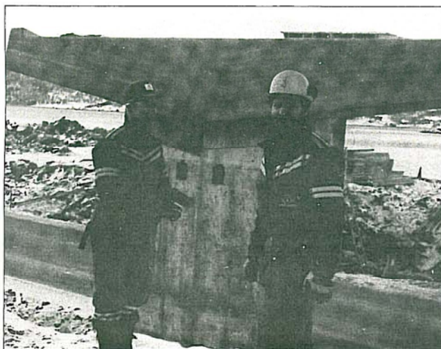
Fortsatt gjenstår en del anleggsarbeid i sørfylket. Hugo Myrbakk og Edgar Haavvik i arbeid med overgangsbru på rv. 19.
