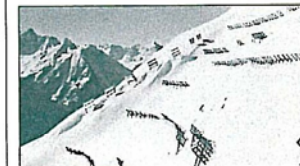
Støtteforbygninger i løseområder for skredet. Man ønsker å holde snøen «på plass» i fjellsiden.
