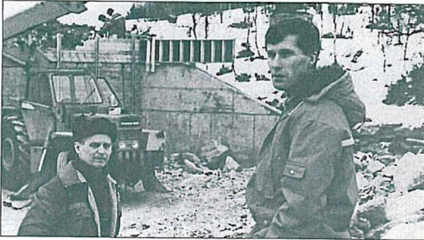
Anleggsleder Toralf Bergseth i samtale med Arvid Lillegård. Bygging av Øverlandsmyra kulvert.
