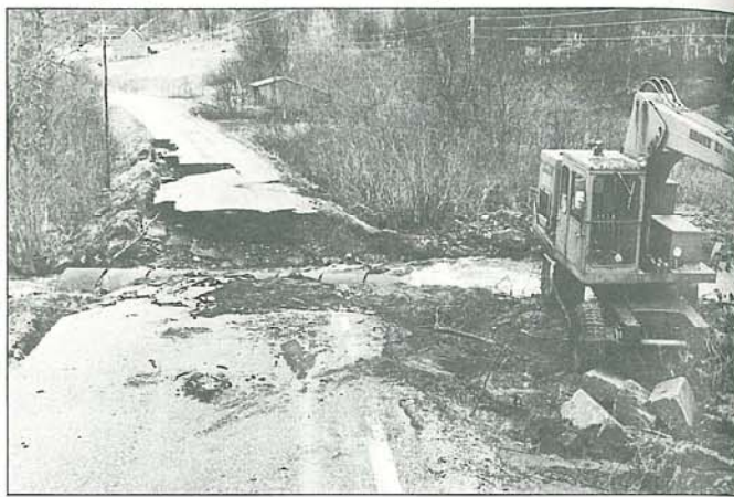
Brudd på fylkesveg nord for Skittenev i Tromsø kommune.
