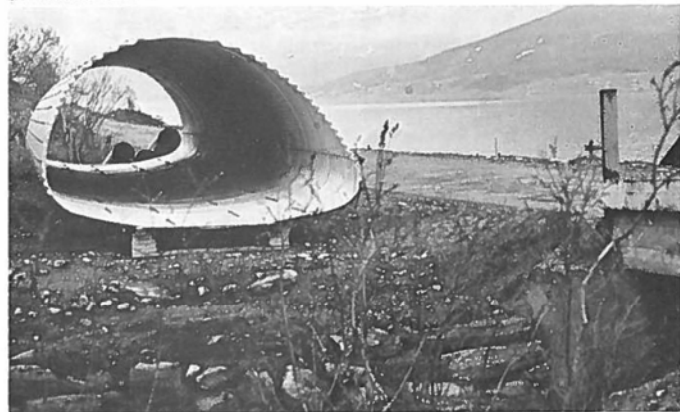
Ti av bruene mellom Burfjord og Finnmark grense legges i rør — her i Mikkeldalselv.
