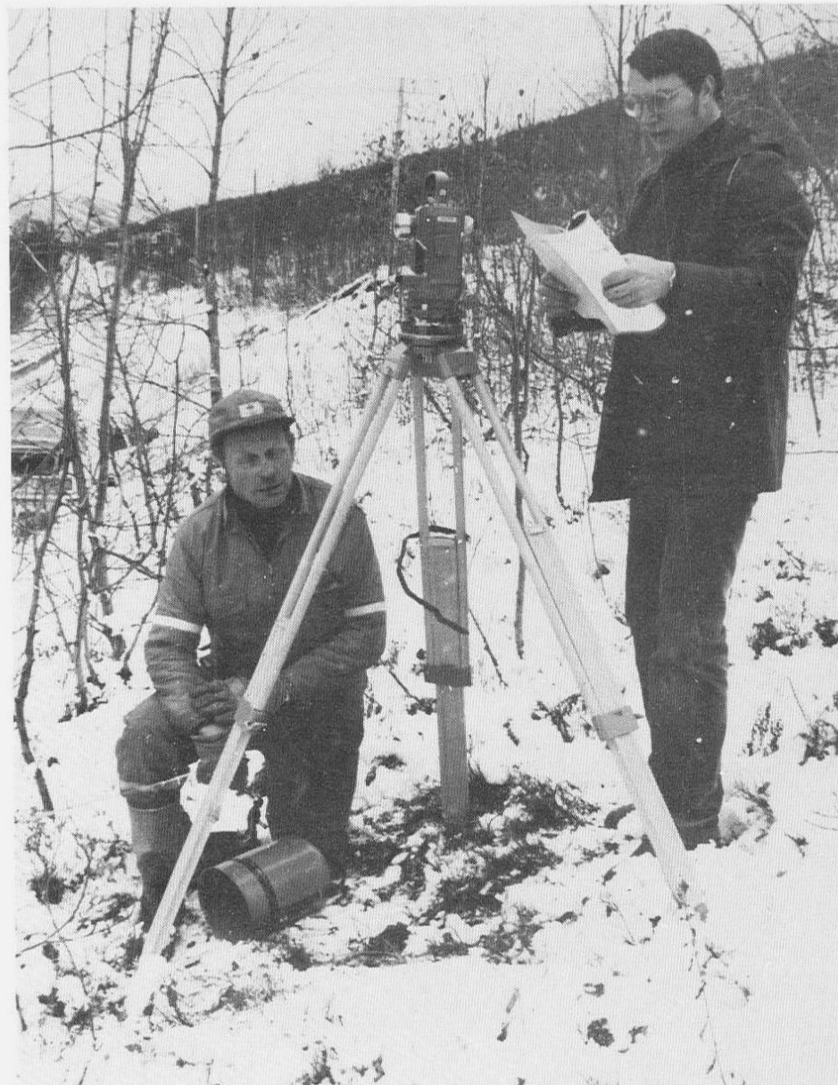
Sneen er allerede kommet, men arbeidet med de siste 3 km frem mot Breivikeidet bru skal fortsette så lenge fornuftig anleggsdrift er mulig. Her avd.ing. Magnar Marthinsen og formann Wilhelm Johnsen.
