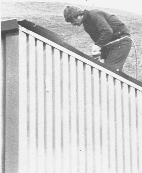
Energiøkonomiseringstiltak ved vegsentralen.
