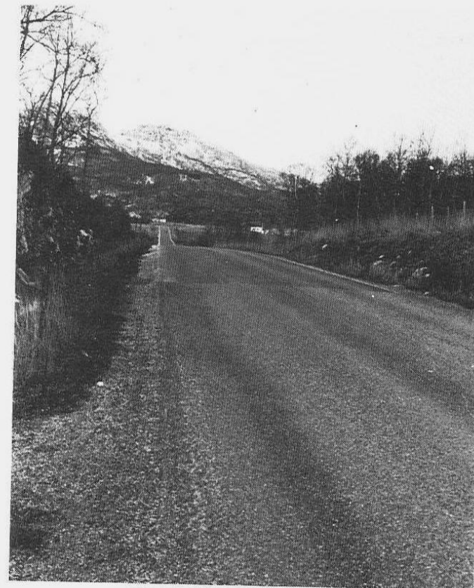
EO-dekke på rv 83 ved Sørvik — vi ser tydelig den grove struktur og forskjell til det gamle dekke.
