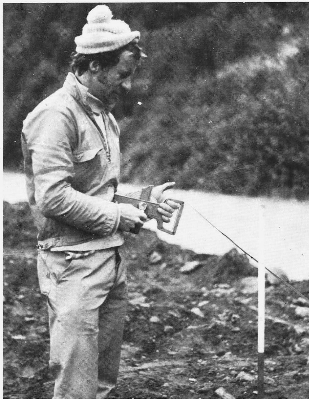
OPPMÅLING er en viktig og ofte daglig funksjon i vegarbeidsdriften. Her Halvor Furnes i arbeid på rv. 6 Kvesmenes — Olderbakken.
