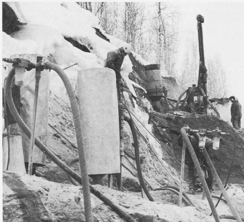
Støvsamlerutstyret, med den nye vannutskilleren som Bardu vegstasjon nå har laget 28 stk. av, høster lovord fra alle hold – her fra rv 851 ved Kistefoss.
