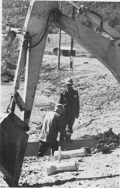
Stikkrenner og andre rør vil nok bli en stor post i 1979 også.
