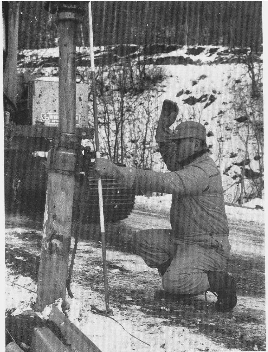
Med litt ekstrautstyr på en Brøyt gravemaskin har vi fått en ypperlig sak for nedsetting av rekkverkstolper – Ingfred Andersen kontrollerer.
