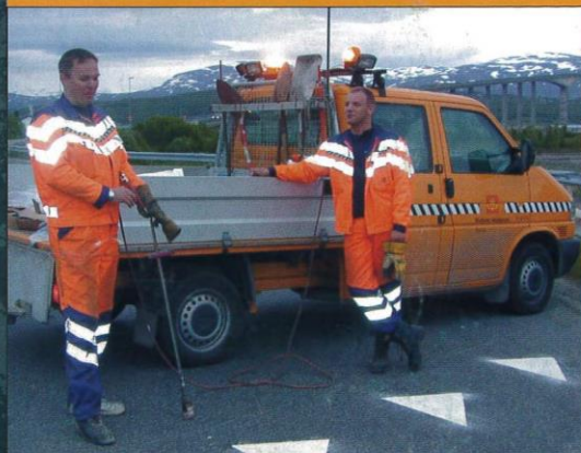
Nattarbeid i midnattsol: Steinar Larsen og Tommy Furumo merker her rundkjøringa ved Sandnessundbrua på Kvaløysletta.
