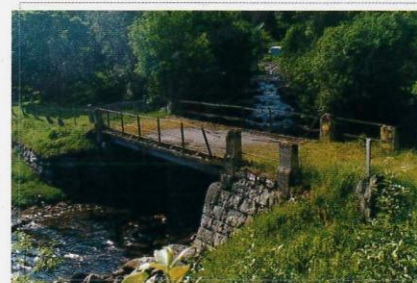
Vegsløyfe og bru i Gausvik, Harstad kommune. Brua og vegen er bygget i 1927.
