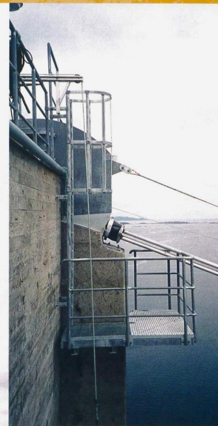
Stålkasse som tilføres tørr luft beskytter kablene på tårntopp mot korrosjon.
