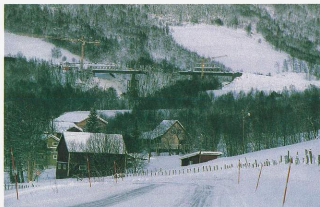
Melev bru på E-8 ligger godt synlig fra dagens E-8. Arbeidene med denne brua utføres i entreprise. Etter en dødsulykke var det stopp i arbeidet på brua i ei uke.
