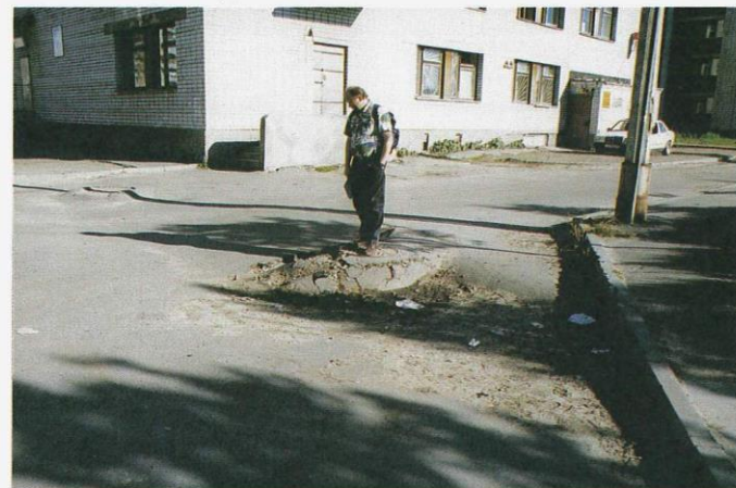
Geir Berntsen betrakter setningsskader i vegen.
