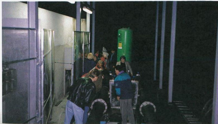
På befaring i Tromsøysund tunnelen. Her ved pumpestasjonen.
