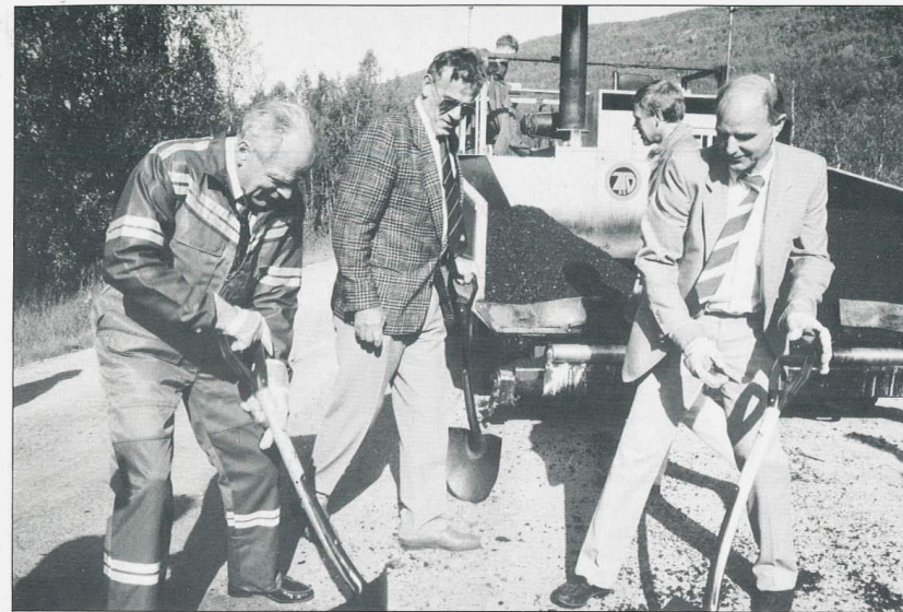
En ekte vegarbeider — og to i dress — fra v. Eskild Jensen, Ole Jakobsen og Eilif Mathisen
