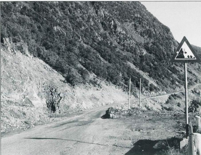
Her går tunnelen inn — og raset «ut» !!!
