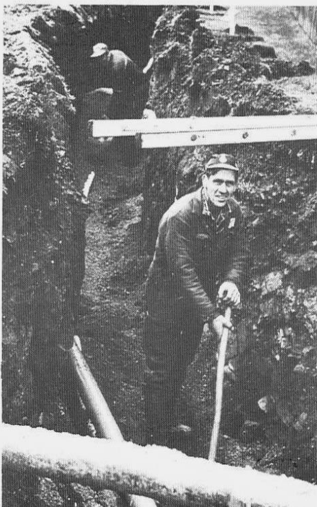
Når det skal tilrigges brakkeleir, må det graves i grøfter også – selv om man er verkstedmann – Finn Mathiassen.
