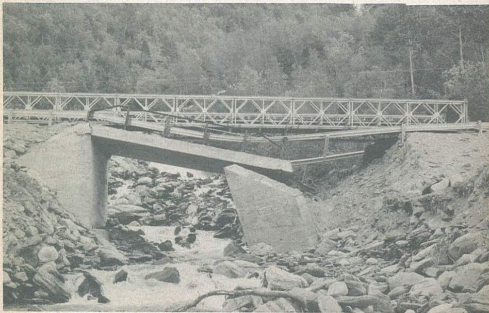
Og så skjedde det — flom tok nye Innerelv bru — en måneds tid etter avleveringen.
