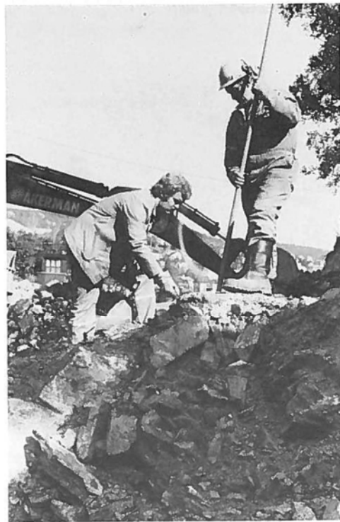
En av de mange sprengningene — Roald Markussen til v. og Einar Kristiansen lader.
