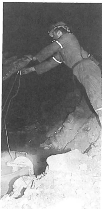
Husøyvegen fikk sin løsning før økonomien ble trang — Arne Johansen setter ned kumme i avløpsgrøft i Fjellsenden tunnel.
