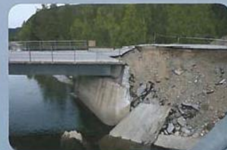
Flomskader Garajokka bru, Alta
