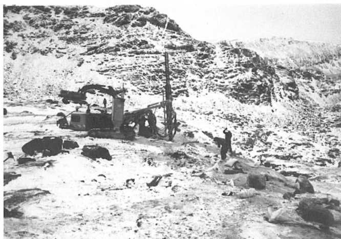
Her foregår det ladning av første salve på gjennomskjæringa og man er igang med boring av neste salve. I bakgrunnen ses en gravemaskin med borerigg som borer for anleggsveg. Utfør fjellet til høyre er det et stup på ca. 50-60 meter.
