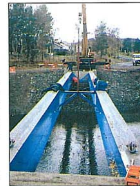
Fra monteringsarbeidet på Tørrfossen bru. Med tiden vil det bli vanlig med farger som skal være med å framheve bruens identitet og estetikk. (Foto: Anleggsavdelingen)
