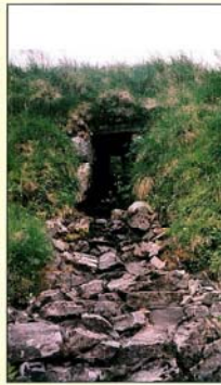
Hopseidet. Eksempel på tørrmurt stikkrenne. Vege er opprinnelig fra tidlig på 1800-tallet, men denne stammer nok fra utbedringa mellom 1936 - 1940.
