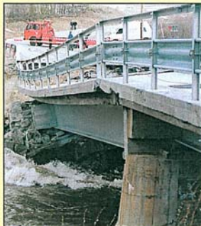
22. mai 2000 klørten 7 om morgenen. Skadene på Munkelva bru er store. I bakgrunnen kan vi se en redningsbil fra Folkens i ferd med å boksere vareløpene som kjørte ned i bruddstedet. Foto: Thorbjørn Mortensen
