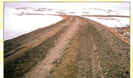
Fra toppen av Smielvdalen. Kun midt i vegbanen er det rester av asfalt. I hjalpoene har vegdekkelet gått helt i oppløsning.
