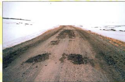
Etter siste vinter er deler av Nordkynvegen nærmest gått i oppløsning som her på toppen av Smielvdalen. Med små midler har Vegvesenet prøvd å lappe vegen for å rette opp de verste hullene.
