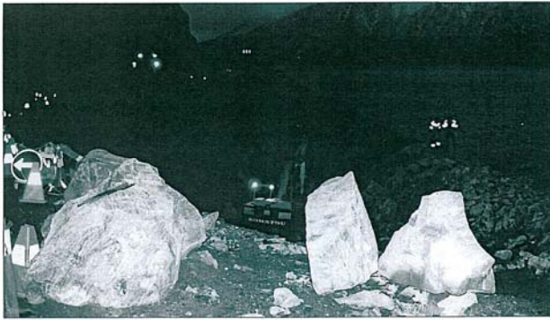
Fylkesveg 77 settes i stand etter at stormen tok _av vegbanen på havet i en lengde på 40 meter.
