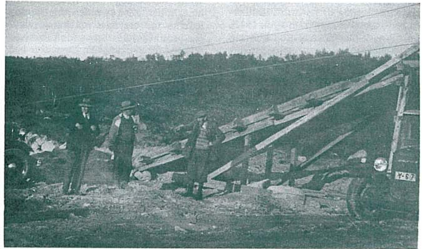
Fra veganlegget Alta — Kautokeino i 1934. Planering med bulldozer og BM-veghøvel, den første i sitt slag i Finnmark. Maskinfører er Harald Næss, Skaidi. De øvrige er, fra venstre: overingeniør Knut Fixdal (sjef for vegvesenet i Finnmark), oppsynsmann Ole Opgård. Mannen helt til høyre er ukjent. I bakgrunnen en Hanomag traktor.
